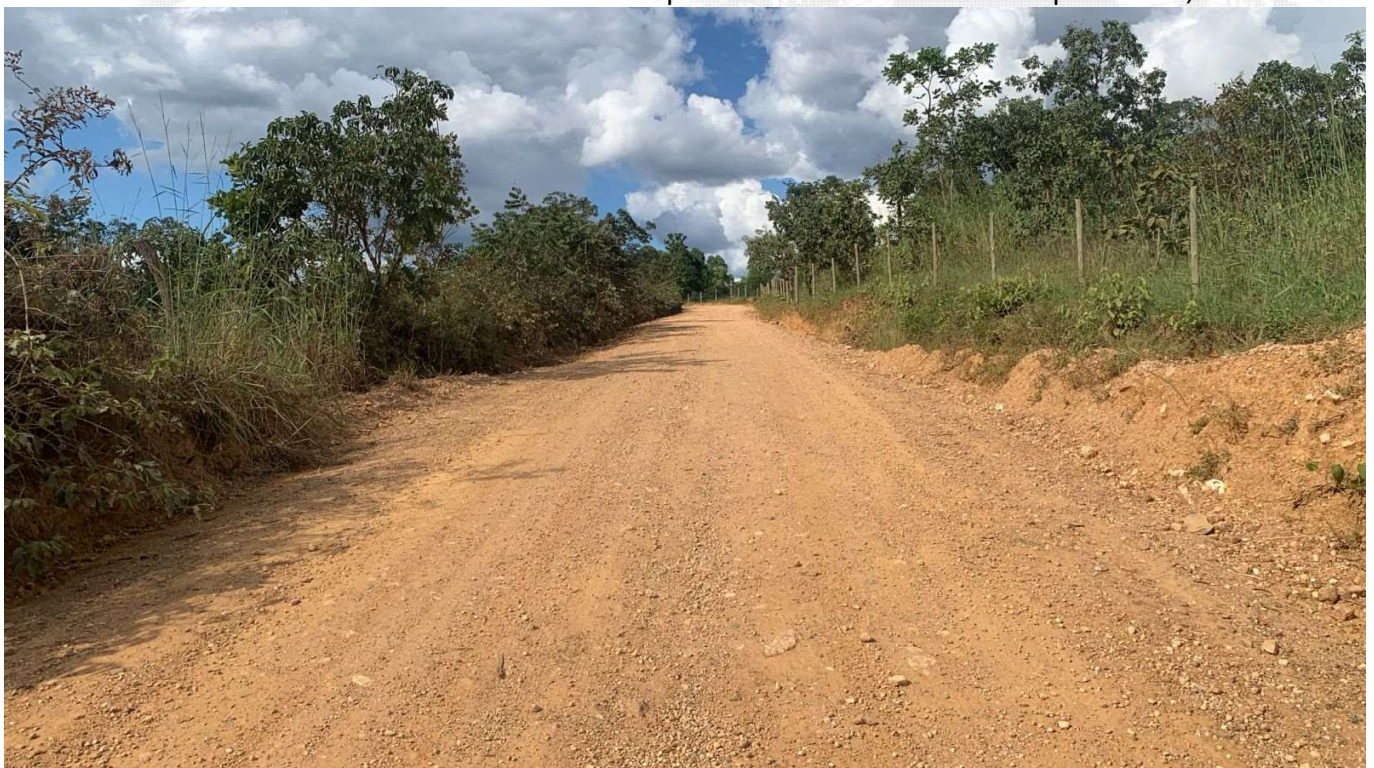
Foto 11: Morro da Cuia, localizado na Estrada Vicinal que interliga os Distritos de Vila Amanda e Vargem Grande à Comunidade da Cuia no Município de Baldim-MG. Fonte: Próprio Autor, 2026.
