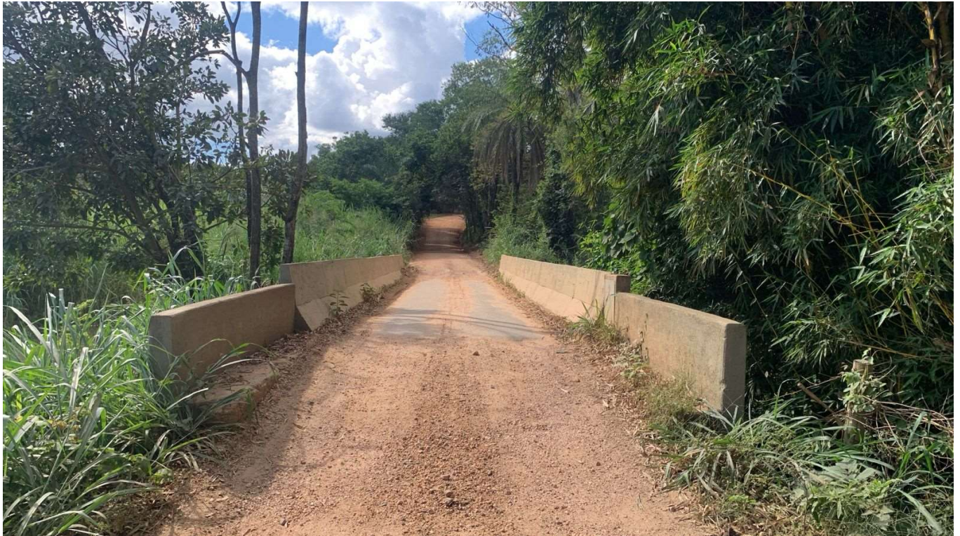
Foto 2: Morro da Cuia, localizado na Estrada Vicinal que interliga os Distritos de Vila Amanda e Vargem Grande à Comunidade da Cuia no Município de Baldim-MG. Fonte: Próprio Autor, 2026.
